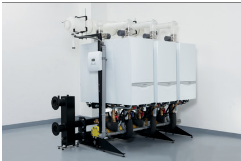
Kaskáda šesti kotlů zády k sobě (příklad montáže bez tepelné izolace)
